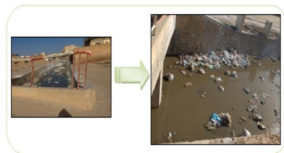
Figure 16: Rejet de l'eau usée non traitée dans l'Oued Ayellou, (collecteur endommagé en 2011)
